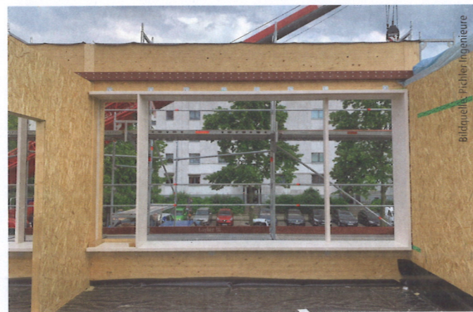
In das BSH-Skelett wurde die werkseitig vorgefertigte, nicht tragende Pfosten-Riegel-Konstruktion aus Fichten-BSH hineingestellt und mit dem Holzskelett verschraubt. Die BSP-Decken in den Gruppen- und Funktionsräumen liegen auf mit Stahlwinkeln befestigten BSH-Attika- und Brüstungsträgern auf.
